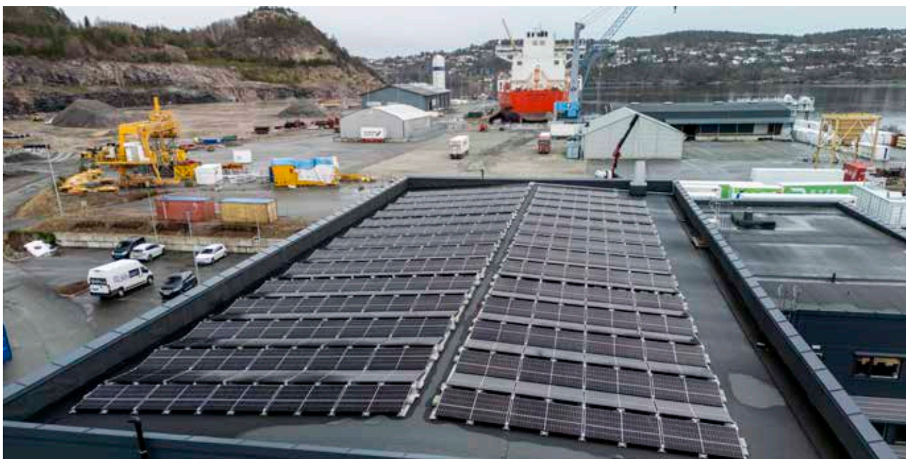
På taket i Vige Havnevei 111, er det installert 251 stk. solceller.
